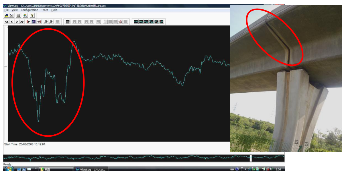
图 15 33-29 号桥墩附近检测的电流波形及接地钢带
